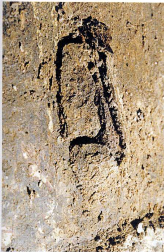
α. Ρωγματώσεις στο θεμέλιο.
